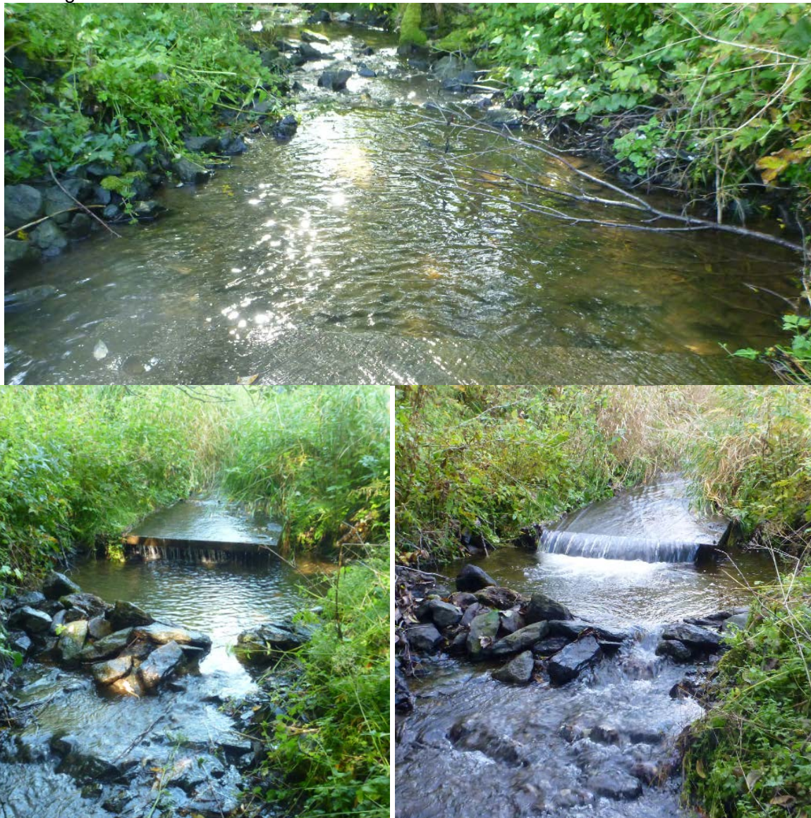
Figur 14. En vannledning er lagt over Valsetbekken, under en mange meter lang betongplate, som har gitt svært lav vanddybde over betongen og et betydelig fall nedstrøms. Bildene viser situasjonen på lav vannføring (under t.v.) og høy vannføring (under t.h.). Det er store vanskeligheter med å passere dette problempunktet for gytefisk, og det er svært viktige gyteområder ovenfor inngrepet. Flere store gytefisk ble observert i denne kulpen høsten 2014, uten muligheter til å komme seg forbi. En terskel av større stein fra bekkeløpet ble derfor lagt ut av NINA (se to nederste foto), som et forsøk på å avbøte situasjonen. Før utleggingen var kulpen grunn og gikk raskt over i stryk (øverste bildet). Tiltaket har hevet vannspeilet i kulpen nedstrøms betongplata. Ytterligere tiltak må utføres for å lette oppgangen av gytefisk på et større vandringsvindu.
